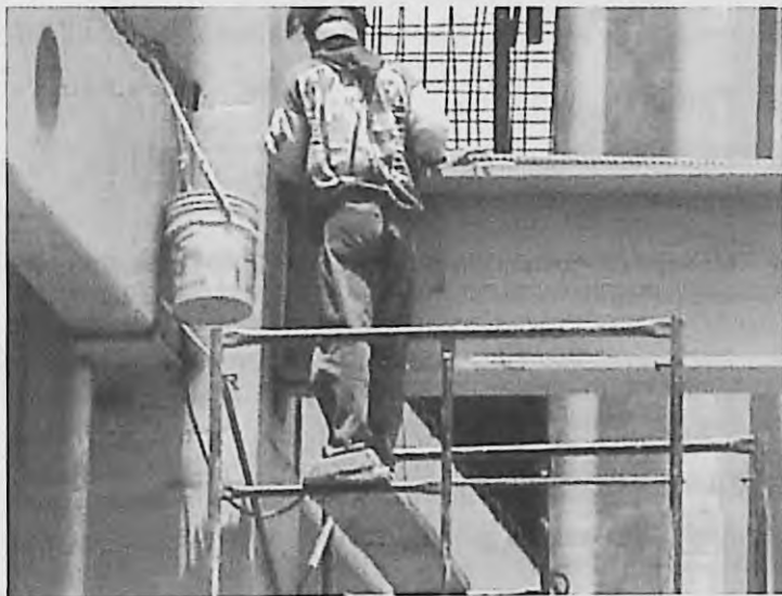
Figura 5.2. Los trabajos de altura generalmente resultan muy peligrosos
